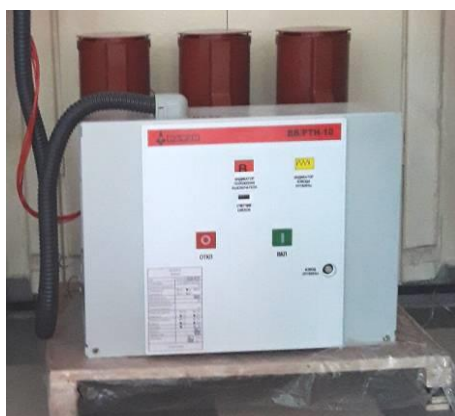
Рис. 1. Высоковольтный выключатель ВВ/РТН-10
